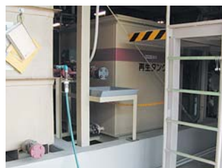
混酸タンクの防液堤
