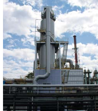
大型スプレードライヤー（滋賀高月）
