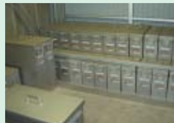
廃PCB含有電気機器の保管状況
