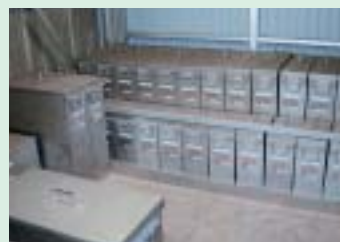
PCB含有電気機器の保管状況
